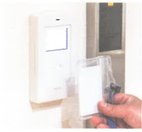
●カードキーをかざすと ロックが解除される仕組み で施設内のセキュ リティを高めています。
